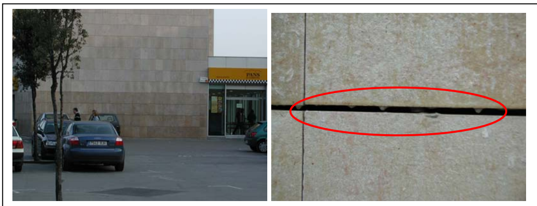
Figur 3.1: Et meget "uheldigt" eksempel på en permanent anti-graffiti behandling på en kalkstensfacade, som helt har ændret facadens udseende og karakter. Nogle af forklaringerne på den markante farveforskel er 1) Påføring af et alt for tykt lag (bemærk tilstedeværelsen af silikonerester i fugen på billedet til højre), 2) Bestanddele i stenmaterialet har "reageret" med bestanddele i anti-graffiti midlet og 3) Gentagne kemiske afrensninger har ændret karakteren af overfladebehandlingen.
